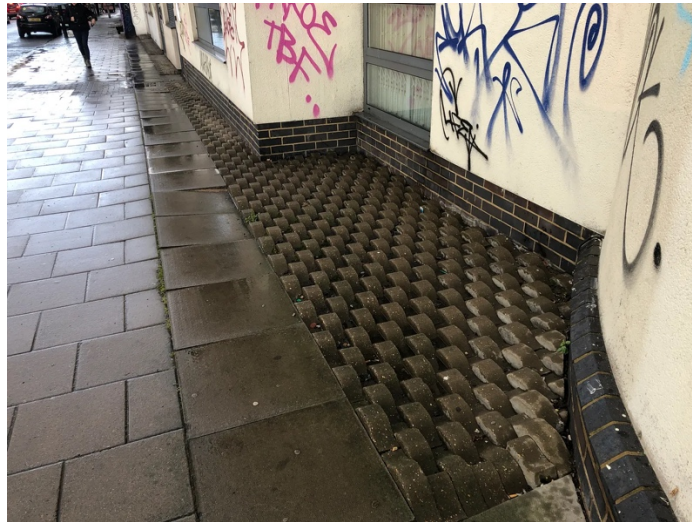
Рисунок 4. Нерівна бетонна поверхня, Camberwell, Південний Лондон, Велика Британія Джерело: W. Hauptfleisch (2024)
